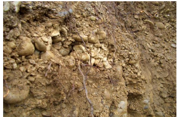
図 8 隙間の大きな礫層
